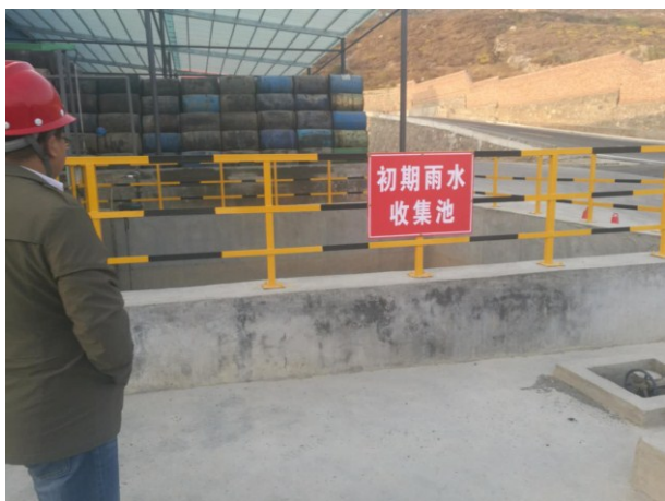
初期雨水收集池
