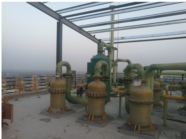
尾气吸收装置
